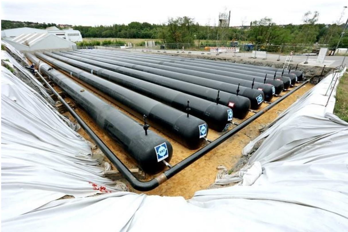
Abb. 84: Röhrenspeicher im Werk Neunkirchen der Saarstahl AG (Copyright Saarstahl AG / Dirk Martin, [51])
