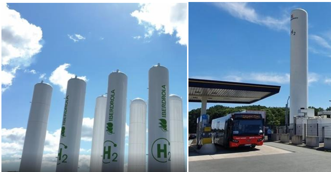
Abb. 81: Stehende Behälter Typ1, Druckstufe bis 45 barg (Quellen: VAKO GmbH & Co. KG, Westfalen AG)
